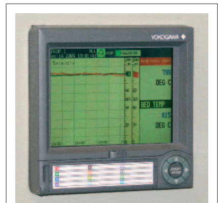
Il registratore a diagramma monitorizza le temperature della camera di combustione del depuratore al fine di documentare l'abbattimento di CO e VOC. Foto MEGTEC.
